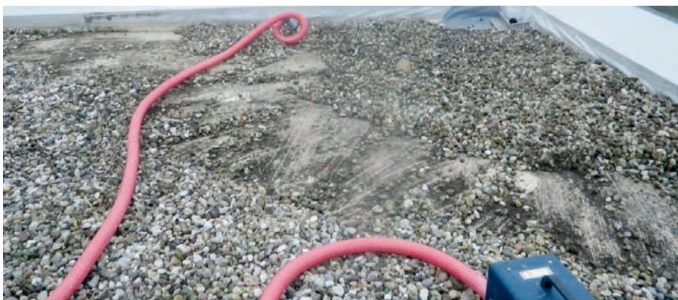
Een dak met kiezelgrind zorgt voor bijkomende problemen: de kiezels moeten eerst worden verwijderd, deels omdat ze lekken ook kunnen verstoppen
