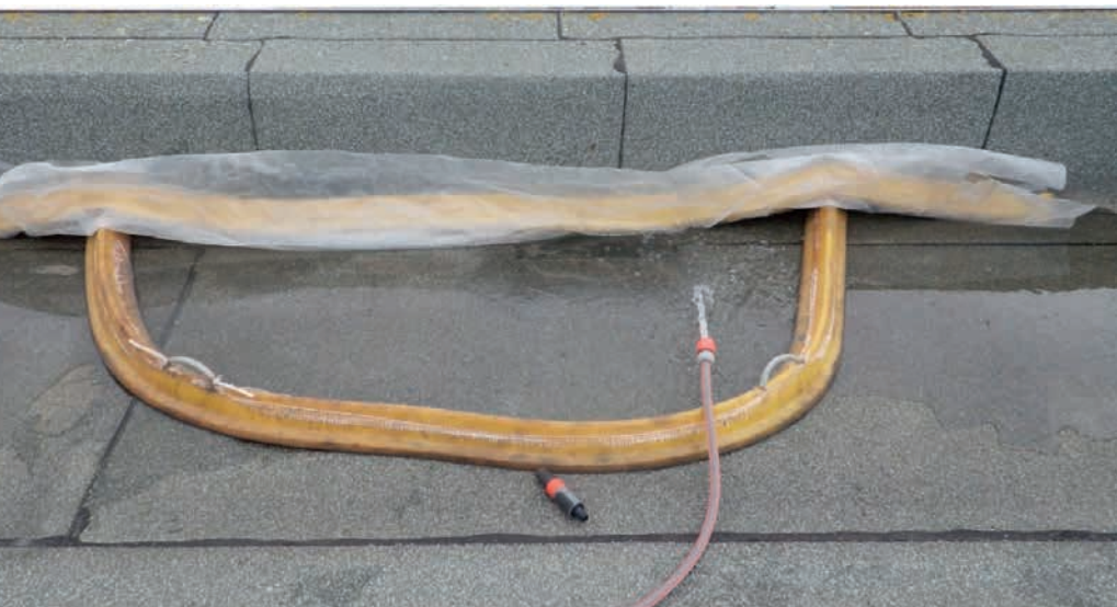
Bij de vloeitest wordt een deel van het dak afgebakend en gekleurd water op uitgegoten. De kleurstof toont dan het lek in de onderliggende ruimte. Het resultaat kan echter weken, zo niet maanden op zich laten wachten
