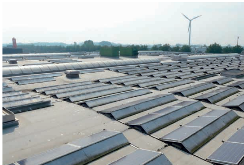
Tal van pv-panelen op industriële daken werden geïnstalleerd tijdens de boom van enkele jaren geleden. Nadeel is dat de plaatsing niet altijd correct gebeurde, waardoor men vandaag met de gebakken peren kan zitten
