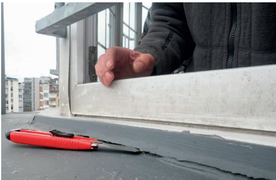
Een plat dak loopt een groter risico op lekkage dan een puntdak. Niet alleen omdat dakpannen sowieso een langere levensduur hebben dan EPDM of roofing, maar ook omdat hier waterplassen kunnen ontstaan
