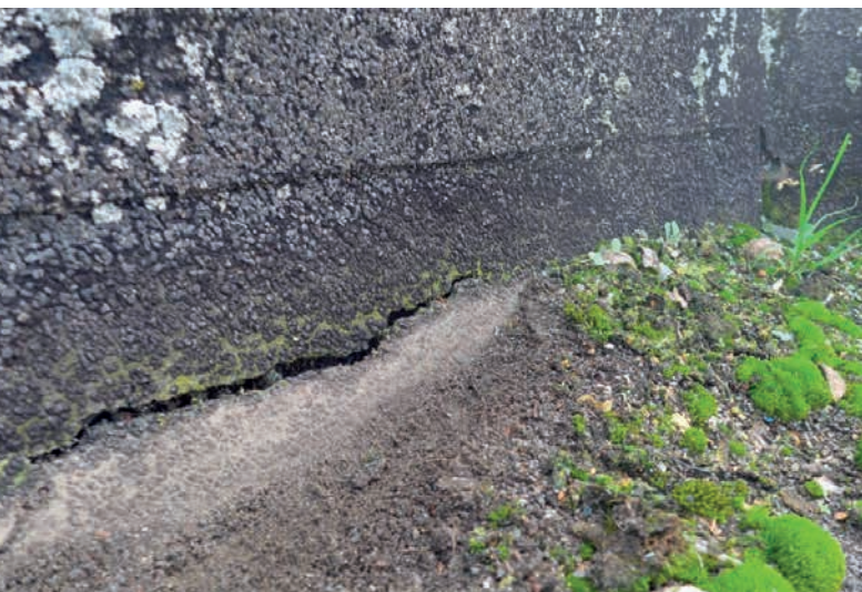
Bitumen is onderhevig aan uv-straling en de weersomstandigheden; vooral de naden en hoeken krijgen het hard te verduren. Het gevolg laat zich raden: scheuren, en een onderliggende isolatie die niet droog blijft
